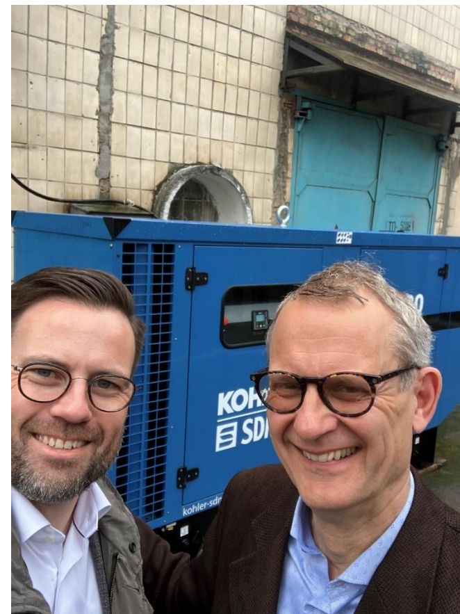
Borgmester Peter Rahbæk Juhl og jeg foran en nødgenerator til et varmeværk, der forsyner ca. 5.000 lejligheder, en skole og en børnehave.
