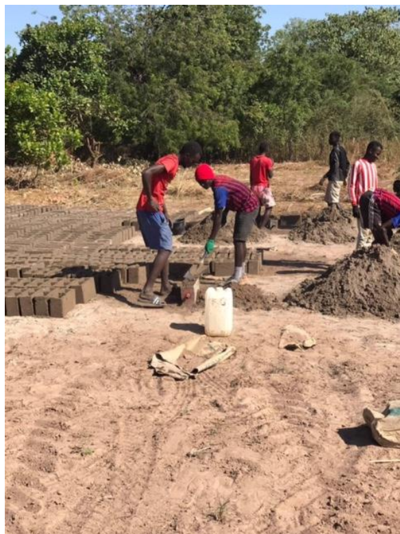
3 teams af unge mænd støber cementblokke til brug for fundament til hegn
