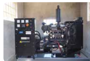
Foto: © Frederiksberg Rotary Klub. Nødgenerator.
